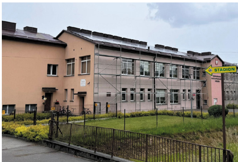
^ Zakres robót objęty zamówieniem obejmował m.in. roboty rozbiórkowe, remont konstrukcji dachu, pokrycie dachu oraz ocieplenie ścian poddasza
